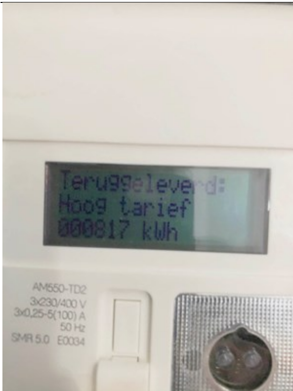
Afb. 15.2 Teruglevering van zonnestroom aan het elektriciteitsnetwerk
