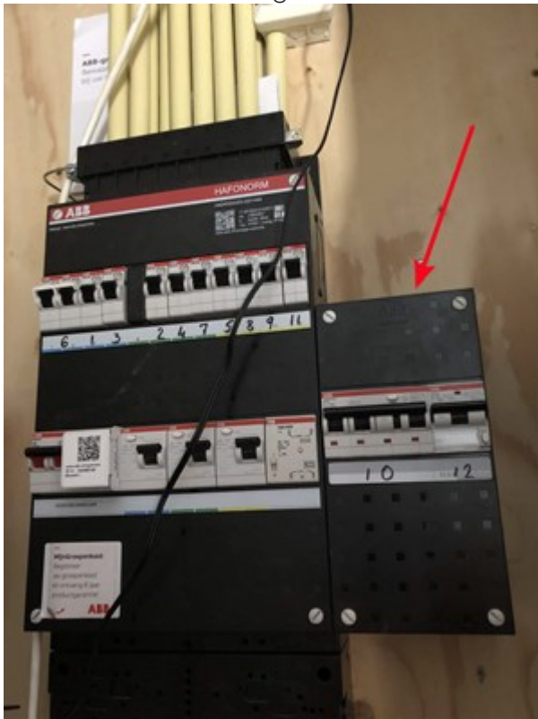
Afb. 15.1 Extra groepen in meterkast voor het PV-systeem
